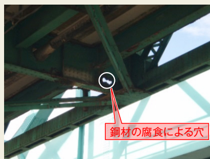
見上げれば欠損
