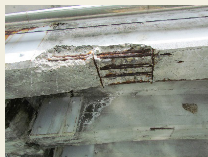
コンクリート桁の鉄筋露出
